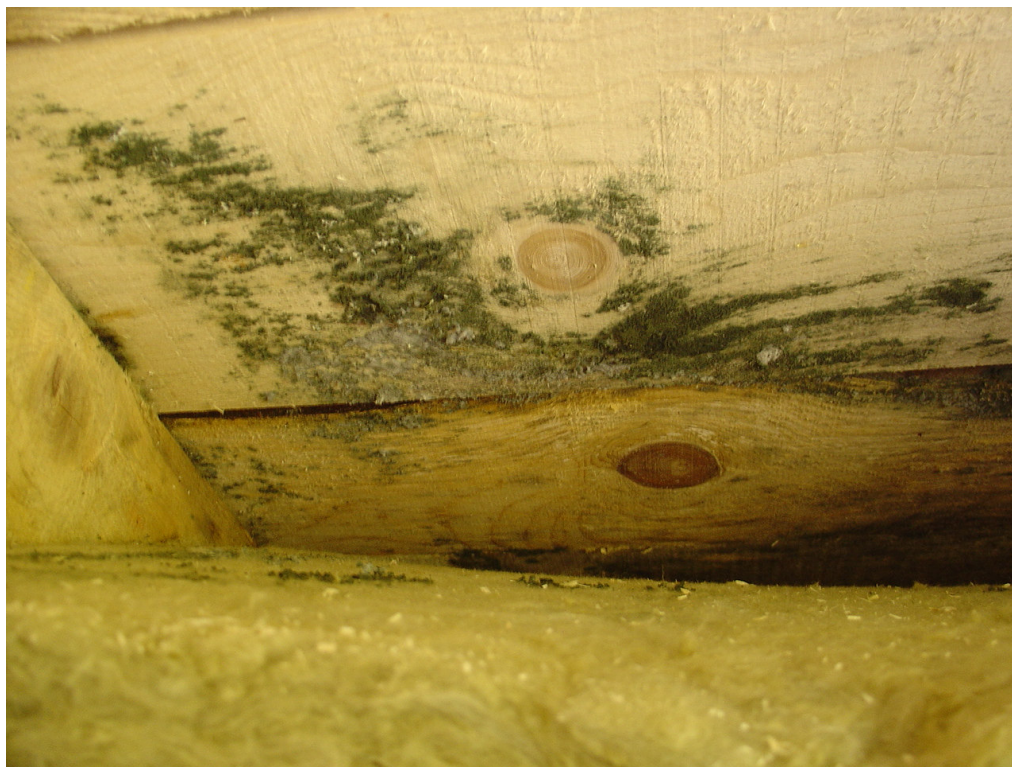
Slika: Nastanek plesni v neprimerno izvedeni strehi
