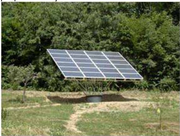
Slika 22: SE Miran Kramberger, Ptuj 3x4,1 kW, zgrajena 2005
