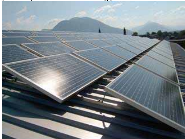
Slika 9: Sončna elektrarna LEA Lesce 16,8 kW, zgrajena leta 2005
