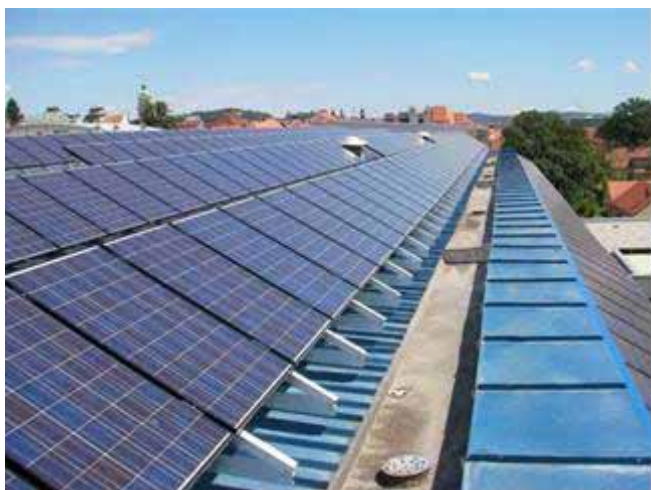
Slika 7: SE Pristan Maribor 35,9 kW, Metal PKS, zgrajena leta 2006
